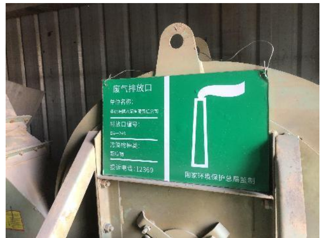
入筛分机的皮带机落料除尘器排放口标识
