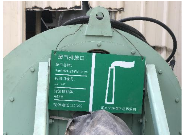
中转至破碎机皮带机落料除尘器排放口标识
