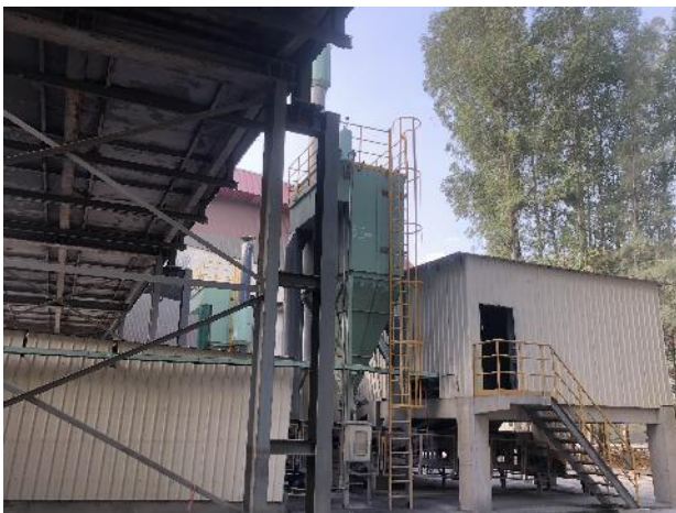
入筛分机的皮带机落料袋式除尘器
