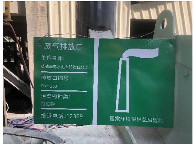
出堆场的中转皮带机落料除尘器排放口标识
