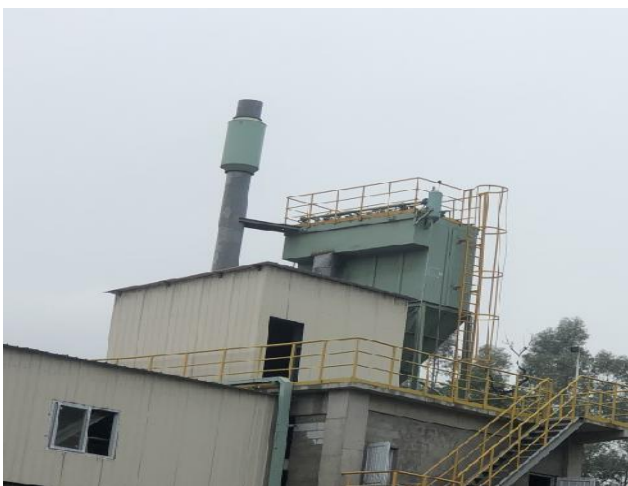
筛分机至骨料库中转皮带机落料袋式除尘器
