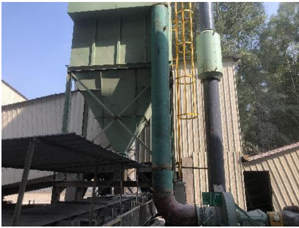
出堆场的中转皮带机落料袋式除尘器
