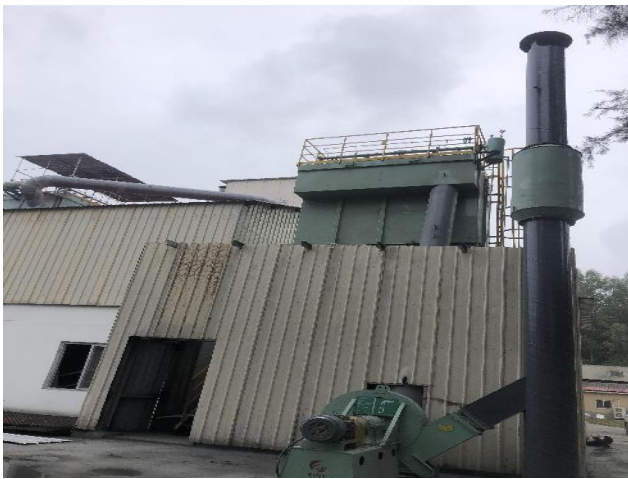
中转至破碎机的皮带机落料袋式除尘器
