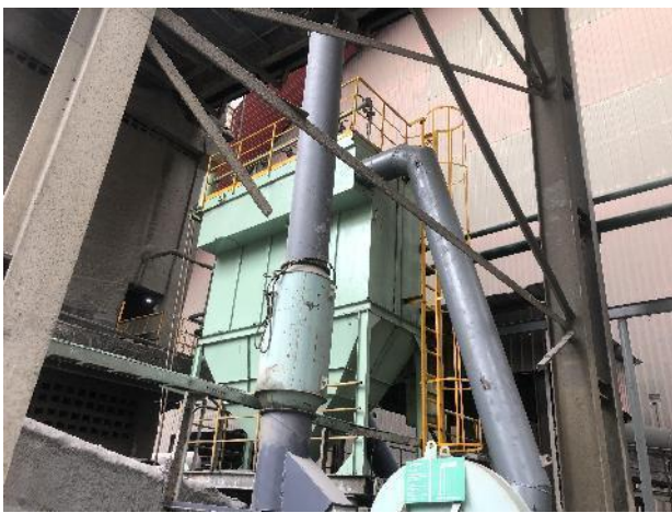
出堆场的皮带机落料袋式除尘器
