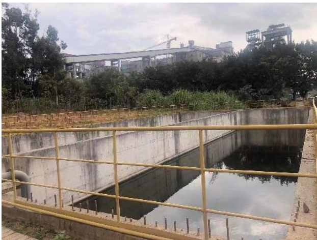
初期雨水收集池
