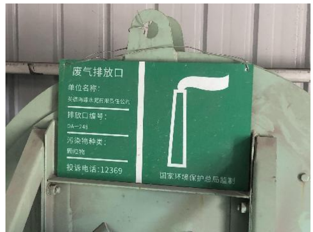
筛分机至骨料库中转皮带除尘器排放口标识
